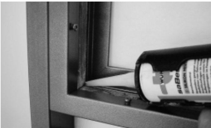
Abb. 13 Abdichten Ecken- und T-Stoss Fig. 13 Etanchéité des joints d'angle et en T
